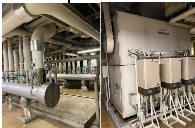
冷温水を循環させる古いタイプの設備。
