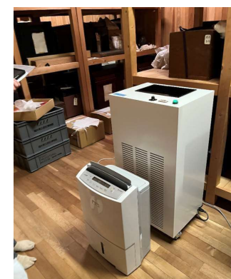
セパレート型の簡易空調設備
