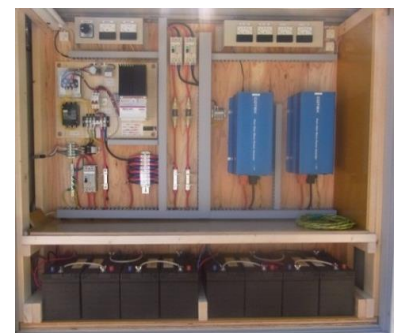
図3 出力制御・充電装置
