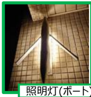
照明灯(ポート)
