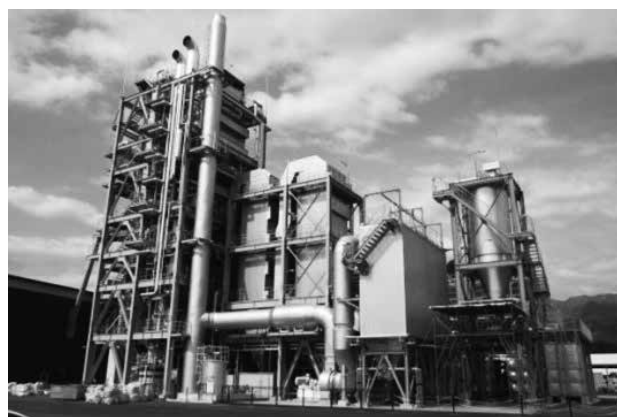
木質バイオマス発電施設（大野市）
